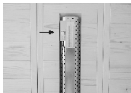
Boîtier de raccordement en haut
